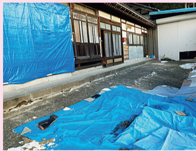
鳥山さんの実家。壊れた箇所は、ブルーシートでの応急措置でしのいでいる
